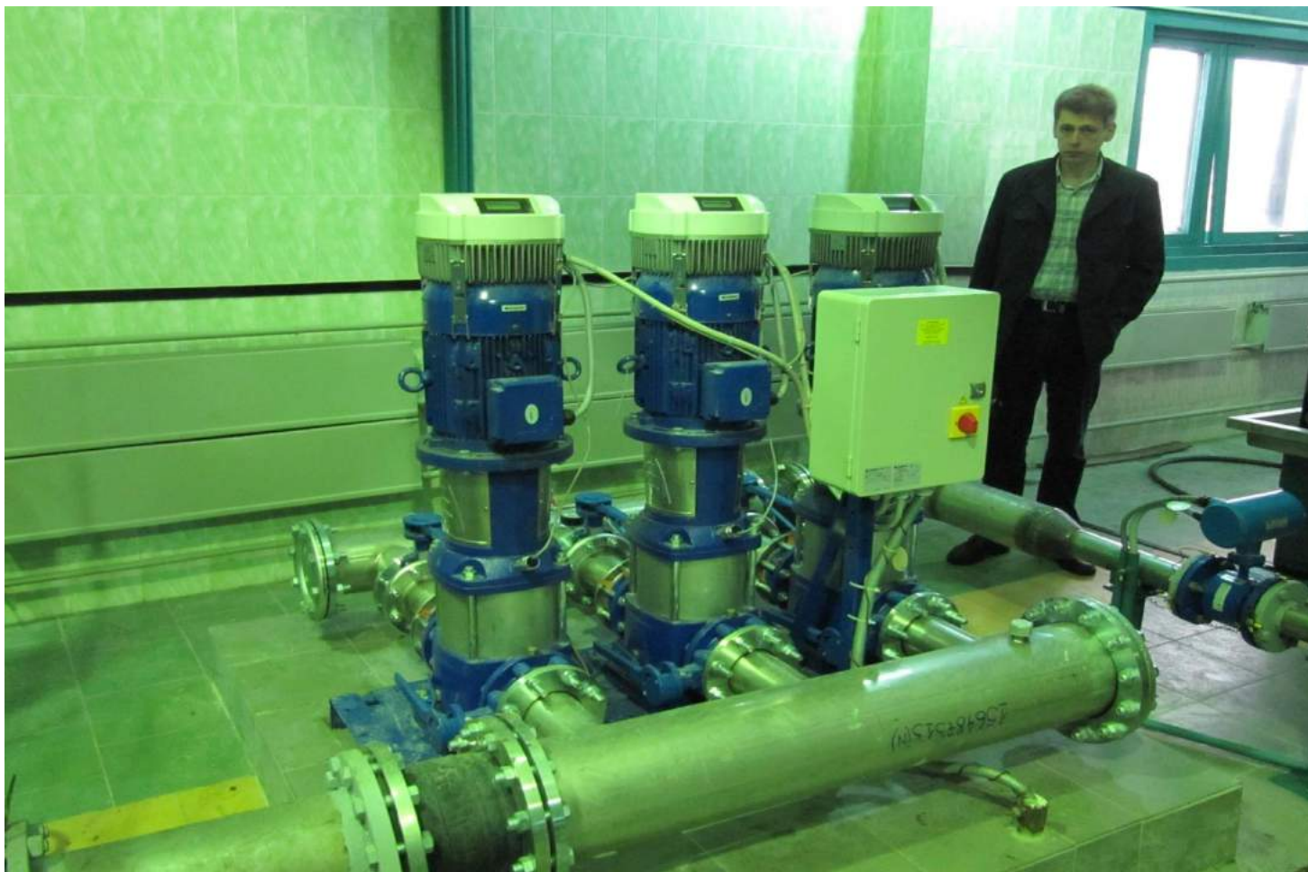
Водоканал г. Новокузнецк (цех мехобезвоживания)
