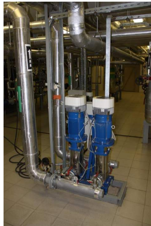
Насосная станция GHV 20
