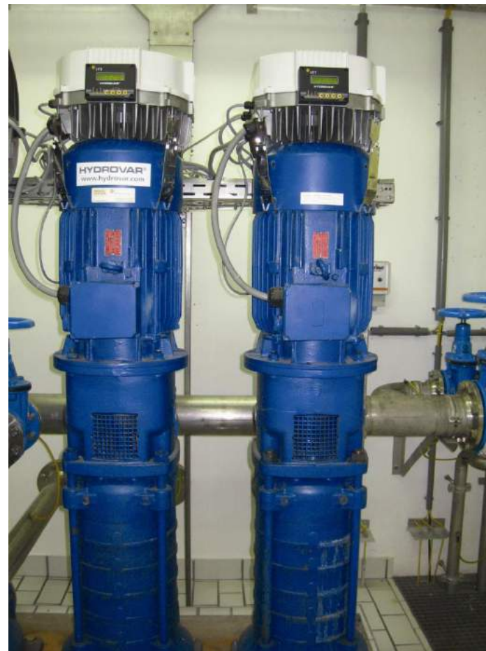
Установка на насосах MPV
