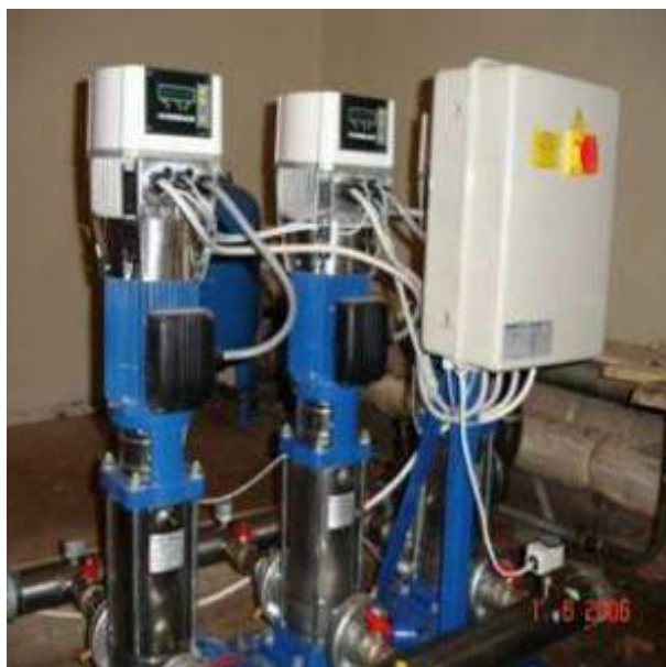
Насосная станция GHV 30
