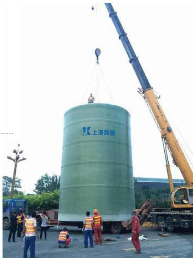
Комплектная насосная станция
