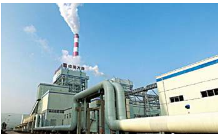
Тепловая электростанция Датанг Баоцзи
