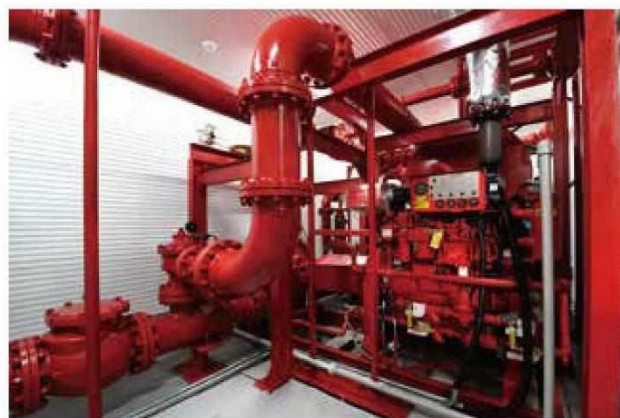
Пожарная насосная станция
