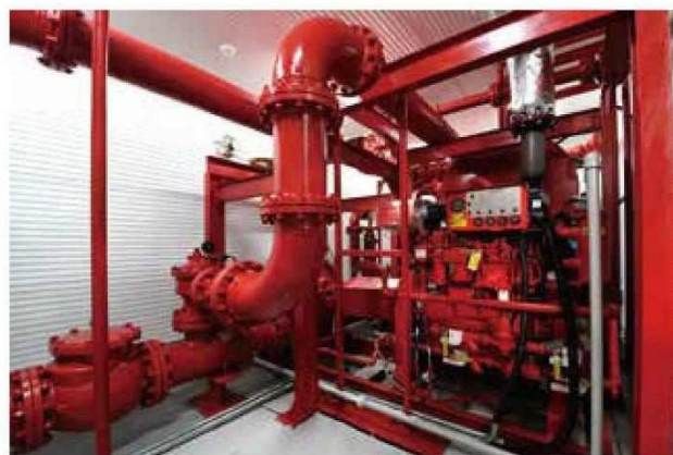
Пожарная насосная станция
