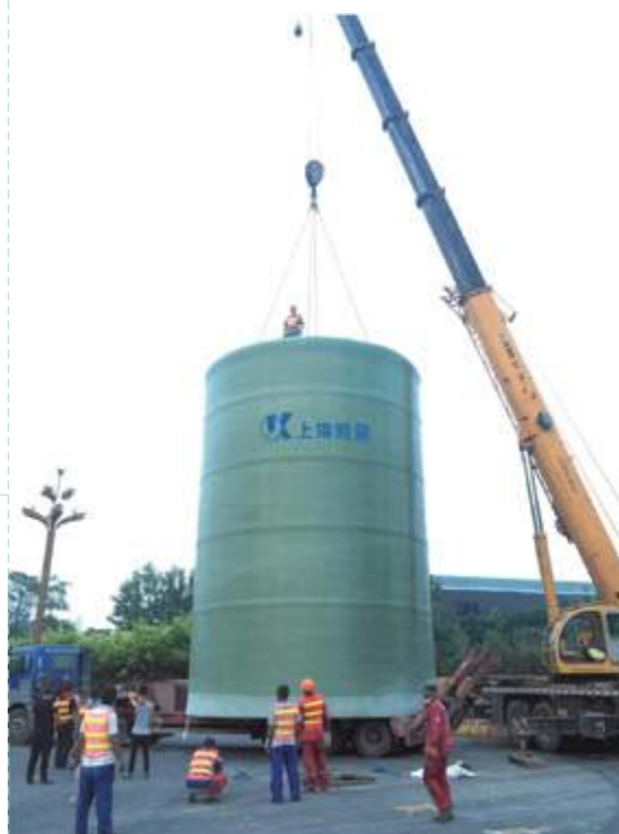
Комплектная насосная станция
