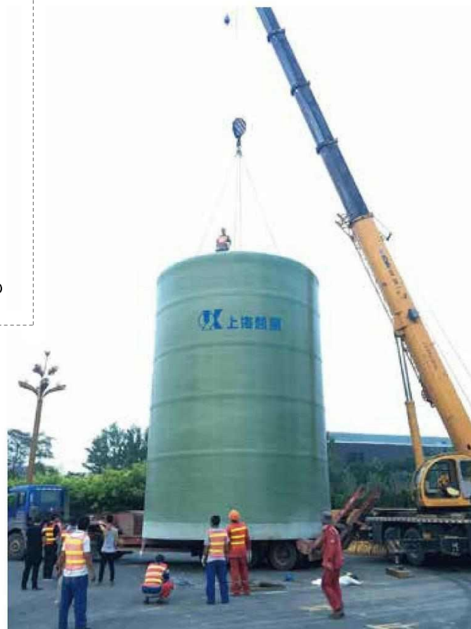
Комплектная насосная станция
